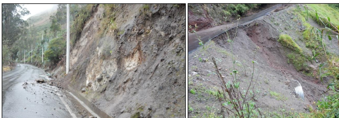
Foto 1. Deslizamiento de tierras en la vía Poatug-Sucre
