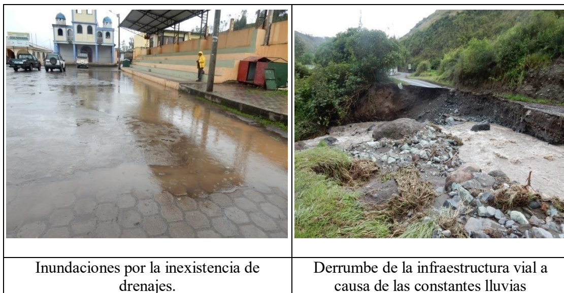
Foto 15. Amenazas en las vías e infraestructura pública.
