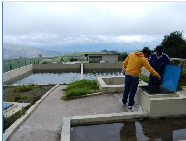
Foto 22. Tanque de agua potable - Parroquia Sucre
