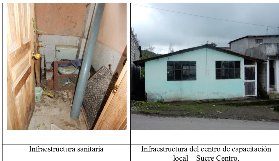
Foto 14. Estado de la infraestructura comunitaria.
